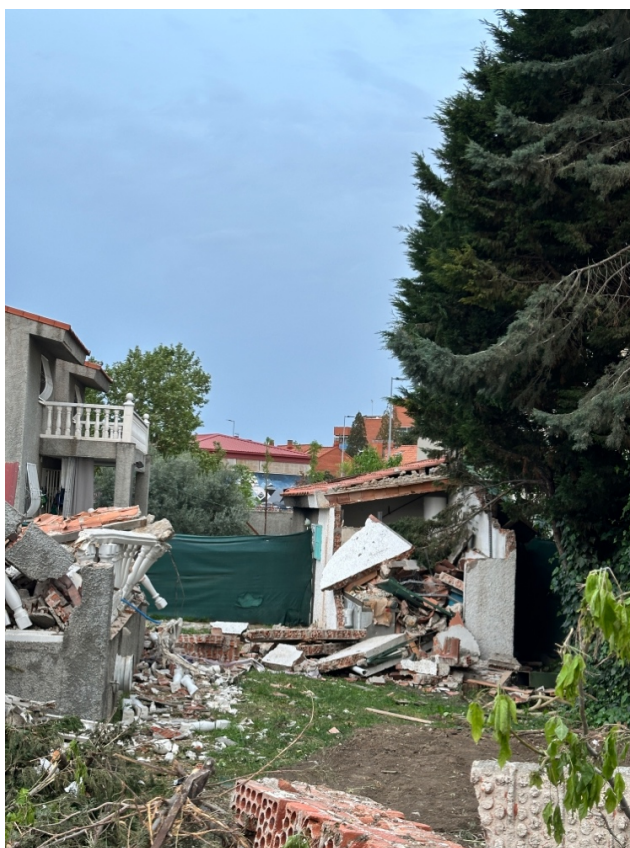
2. Escombros de la vivienda derribada el 20 de abril (estructura de ladrillo, no chabola ni infravivienda).
